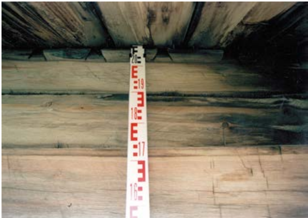
Рис. 58. Пос. Горнокнязевск Приуральского района ЯНАО. Летний жилой дом Е.Н. Тайшиной. Фрагмент южного фасада. Пазы утраченной обрешетки от первоначальной кровли в верхнем продольном венце. Fig. 58. Gornoknyazevsk settlement, Priural district of the Yamal-Nenets Autonomous Okrug. Summer residential building of E. N. Tayshina. The southern facade. Grooves of lost sheathing from the original roof in the upper longitudinal level.
