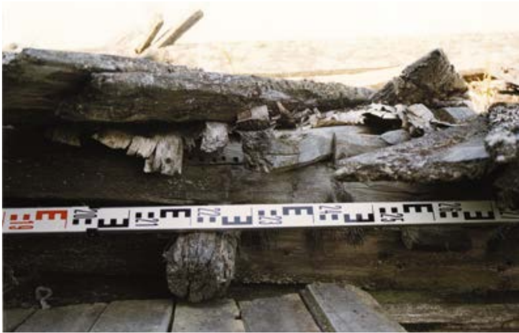
Рис. 118. Пос. Горноknязевск Приуральского района ЯНАО. Хозяйственный амбар Е.Н. Тайшиной. Фрагмент юго-восточного фасада. Вкладыш для крепления стойки каркаса к стеновому ограждению. Маркировка венцов высверленными отверстиями. Врубка курицы. Кровельная гидроизоляция – берестяной ковер. Деревянный вкладыш – полица. Fig. 118. Gornoknyazevsk settlement, Priural district of the Yamal-Nenets Autonomous Okrug. Household barn of E. N. Tayshina. Southeastern wall. Insert for attaching the frame post to the wall fence. Marking of plancks with drilled holes. Roof waterproofing – birch bark carpet. Wooden insert – politca.
